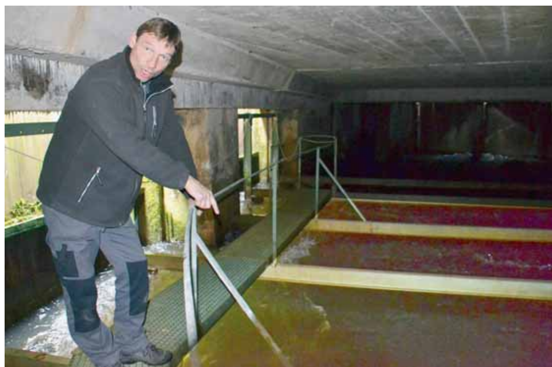
Olivier Clerc dans la centrale du Furcil. 10 m3 d'eau par seconde défilent sous ses pieds, à la sortie de la turbine.
